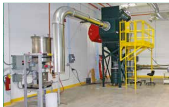
ASHRAE Standard 199 dammtestningsinstallation
